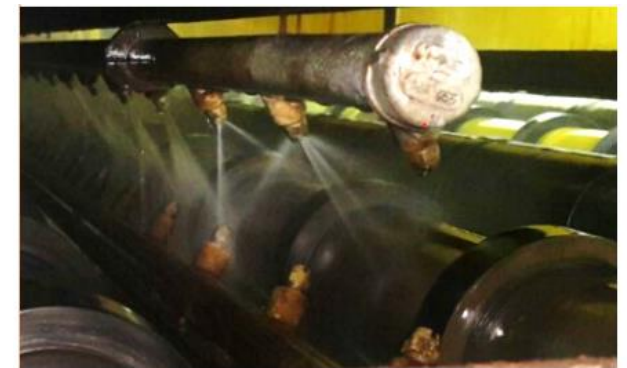
VFGの受賞対象の設備
