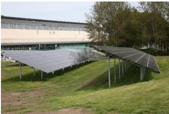
事業所内の太陽光発電設備
