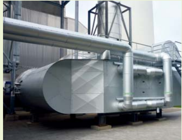
ドイツのヴァイハマー事業所に設置された廃熱ボイラー
