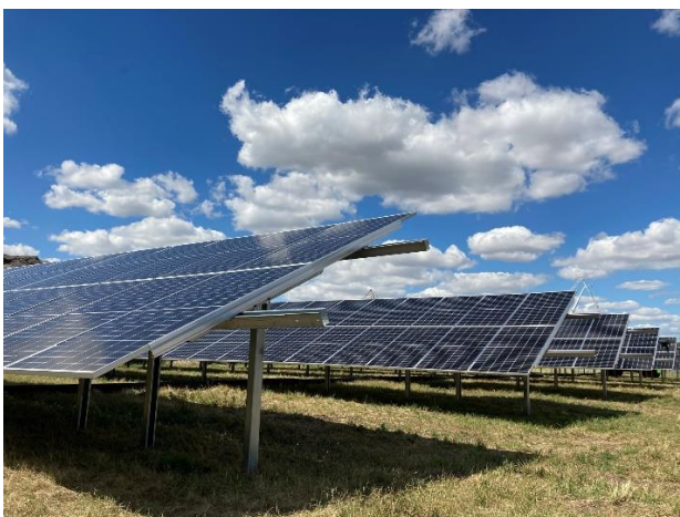
敷地内に設置された太陽電池パネル
