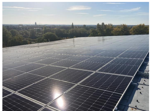
建屋屋上に設置された太陽電池パネル
